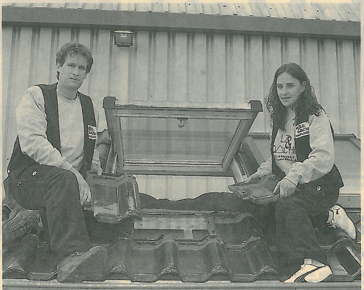
Dachdeckerin Vanessa Conrad und ihr Chef Thomas Leyherr von der Firma Holz und Dach in Saarlouis arbeiten in luftiger Höhe.
